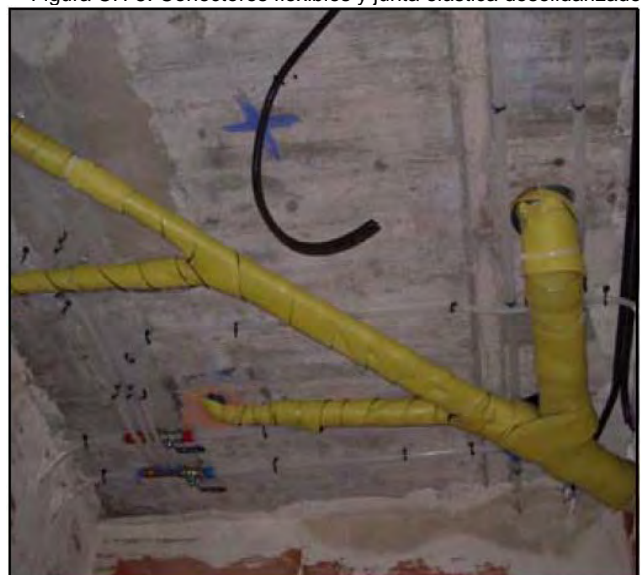
Figura CH-7. Aislamiento de pulpo de desagüe
