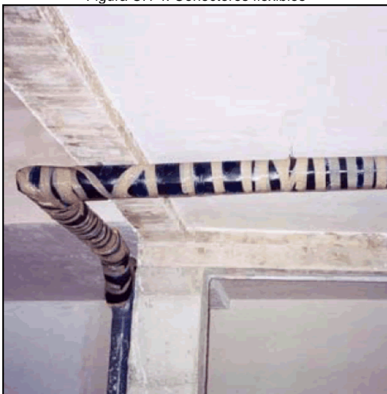
Figura CH-6. Aislamiento de colector de evacuación
