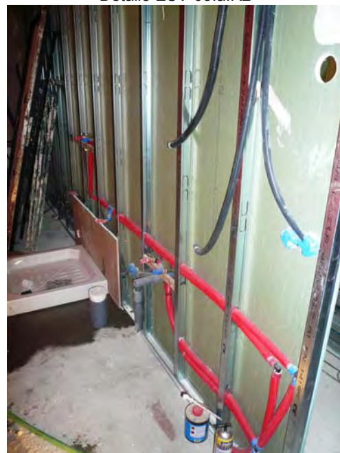
Detalle ESV-03.a.R3. Instalación correcta de las tuberías entre los perfiles de las placas de yeso laminado.
