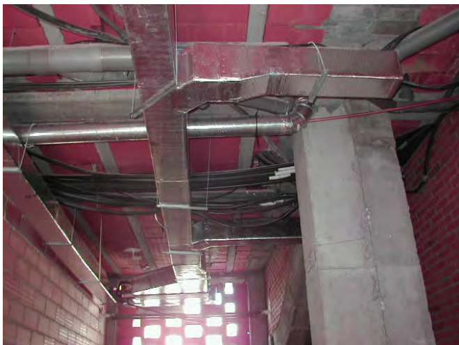
Figura CLI-03. Ejemplo de conductos de climatización
