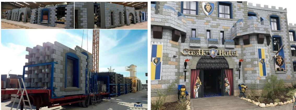
Figura.- 900 m 2 de paneles GRC Sandwich para el Hotel Legoland en Windsor (Inglaterra). Arquitecto: Manser Practice Architects + Designers
